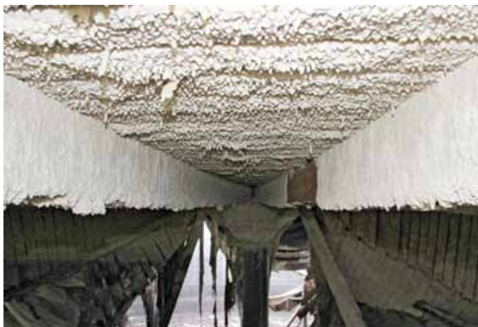
Zentimeterdicke Ablagerungen bilden sich im Inneren des Biogasbehälters innerhalb von kurzer Zeit
