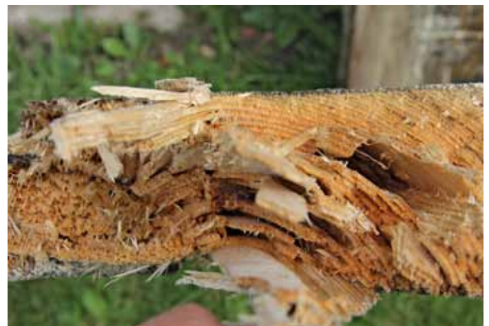
Die Holzzerstörung erfolgt – wie dieses Bild zeigt – nicht nur äußerlich, sondern auch im Inneren der Sparren
