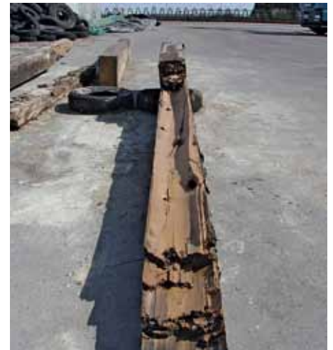
Aufgelöste Mittellamellen führen zu einer Zerstörung des Holzgefüges
