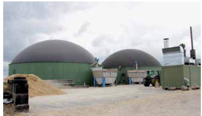
Abb. 2: Landwirtschaftliche Biogasanlage mit zwei Fermentern und Blockheizkraftwerk; das Problematerial stammt aus dem linken Fermenter
