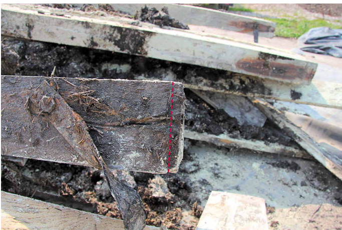
Abb. 11: ausgebauter Sparren, der schon vor dem Rückbau im Substrat lag und an dem auf Grund der Abdrücke eine Auflagetiefe von 2 cm festgestellt wurde
