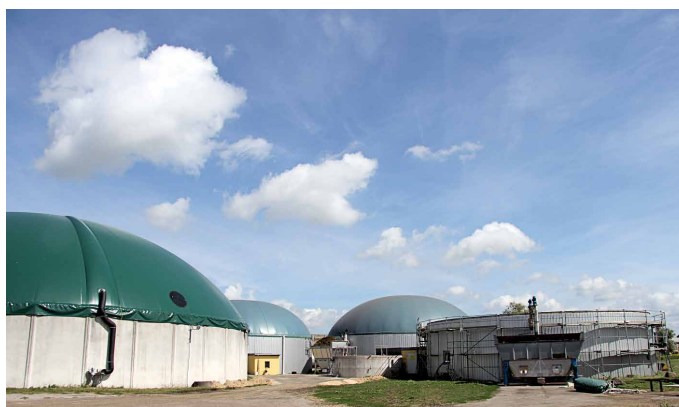
Abb. 1: Ansicht der untersuchten Biogasanlage, vorn rechts der geschädigte Fermenter nach Rückbau des Dachs
