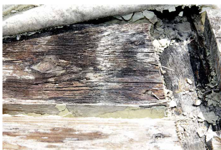
Abb. 4: verfärbte, mazerierte Holzoberfläche
