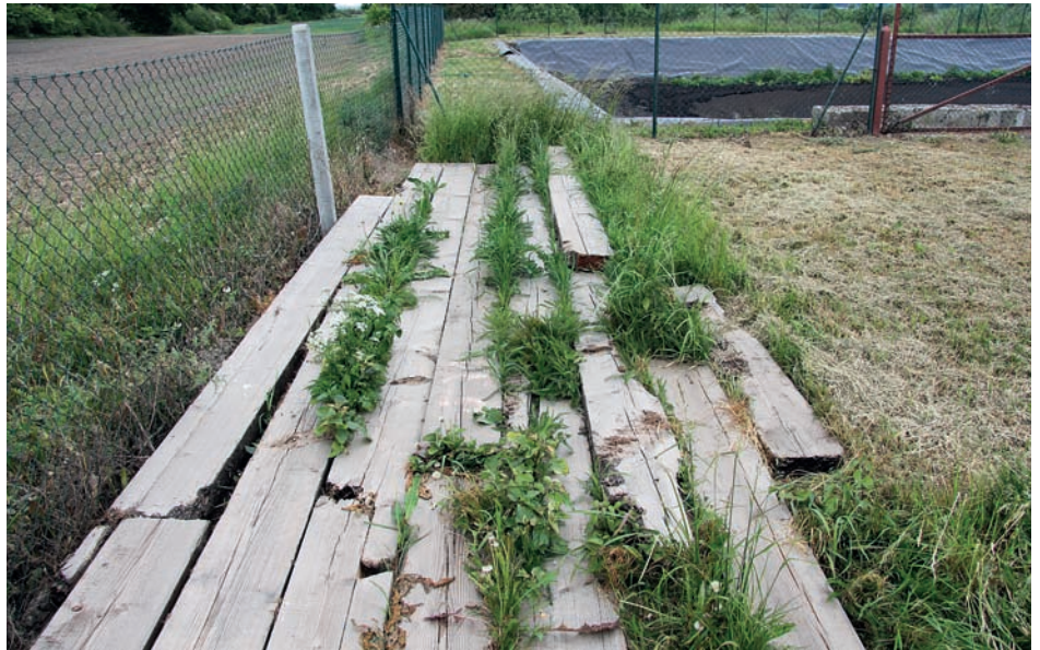
Abb. 1: Bruchbalken. Abb. 2: Bruchstelle (unten).
