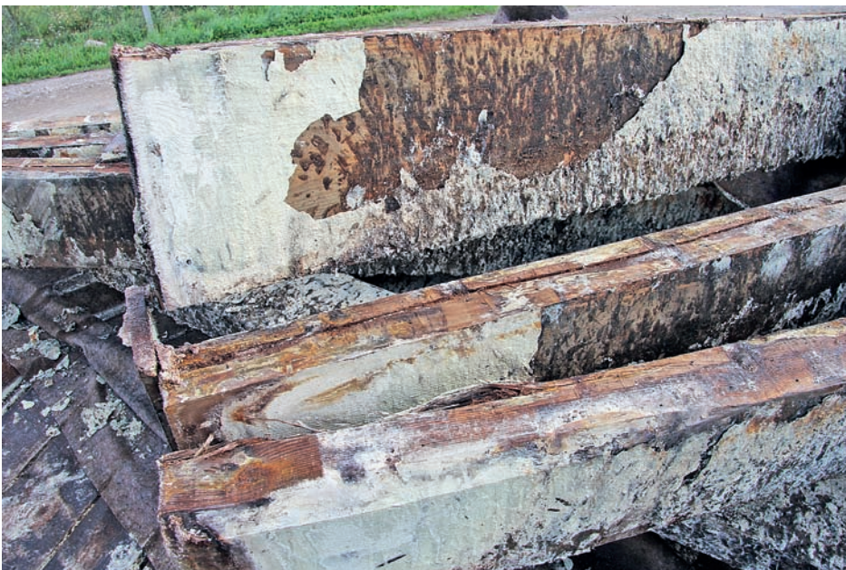
Abb. 4: Fermenter in der Sanierung (oben). Abb. 5: Schwefelablagerungen.
