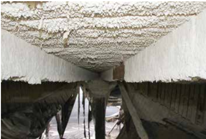
Abb. 4: Schwefelablagerungen auf der Unterseite einer Holzdecke
