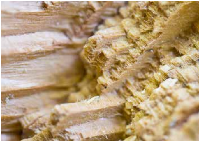
Abb. 8: Bruchstelle eines Balkens mit kurzfaserigem Bruchbild
