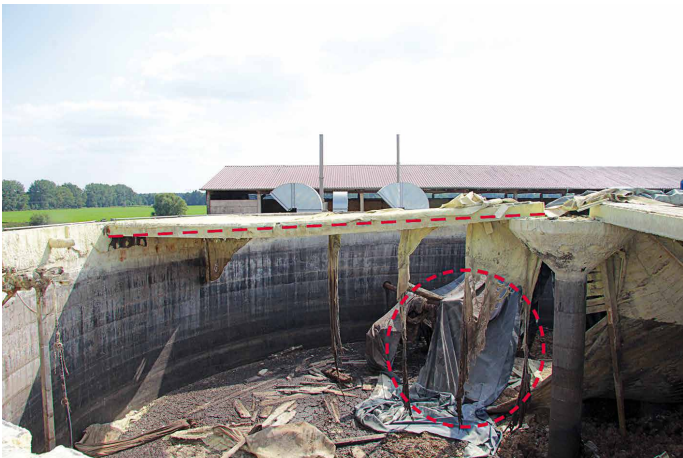
Abb. 9: Sparren mit sichtbar starker Durchbiegung, darunter durch die Gasfolie verdeckt der sog. (zerstörte) Paddelgigant
