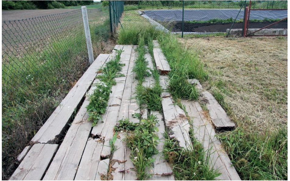
Abb. 1: Bruchbalken. Abb. 2: Bruchstelle (unten).
